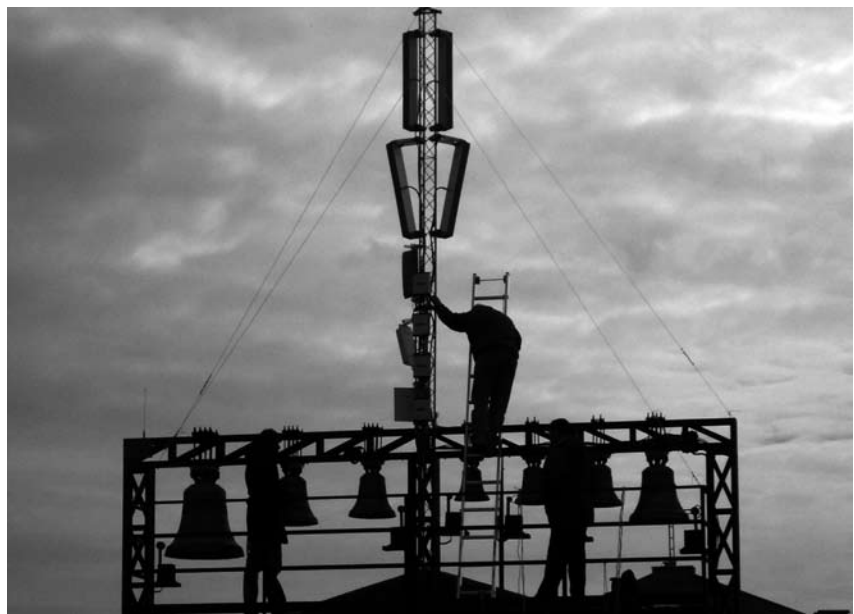
Installazione di Witech presso la Chiesa di Madonna delle Grazie (Sora FR).
